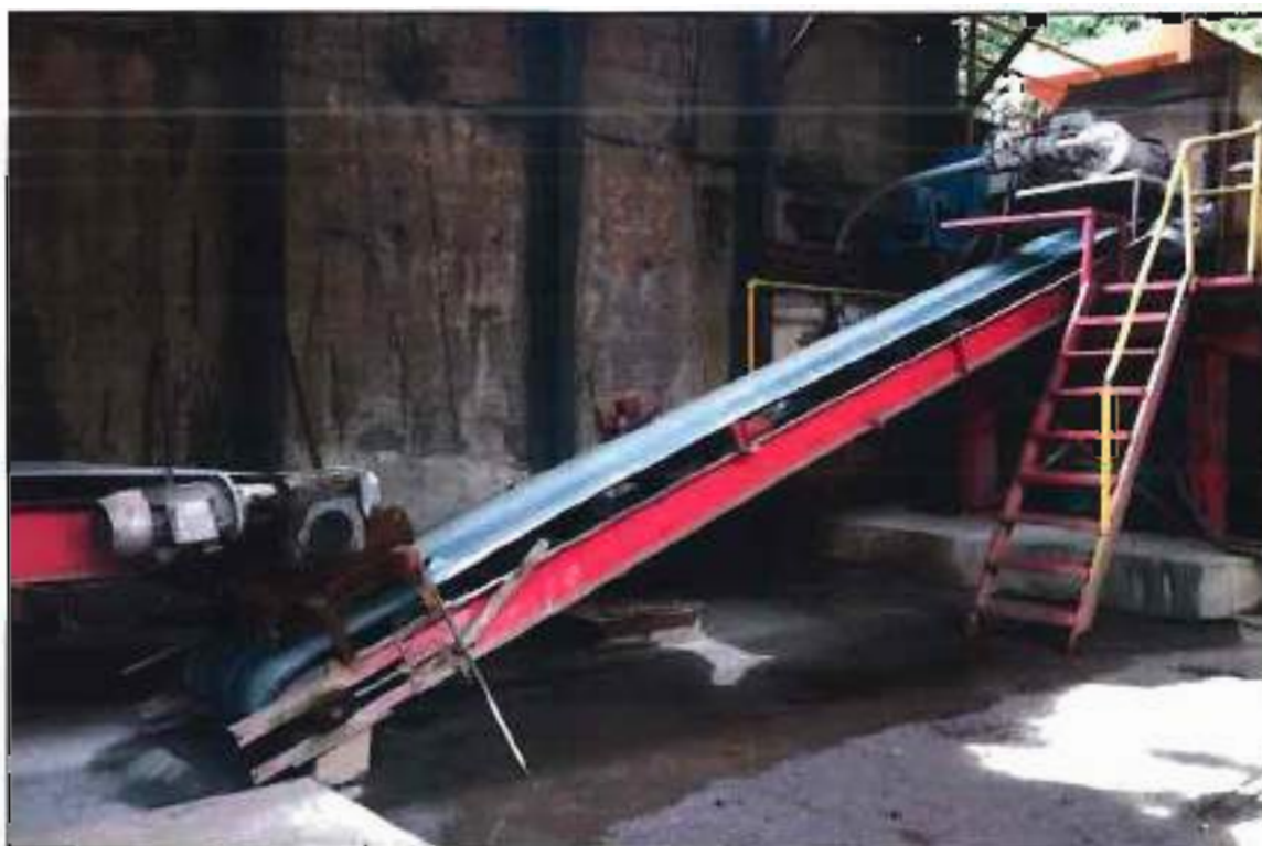
ITEM 1,003 – VISTA DA CORREIA TRANSPORTADORA DA LINHA USINA DE ASFALTO
