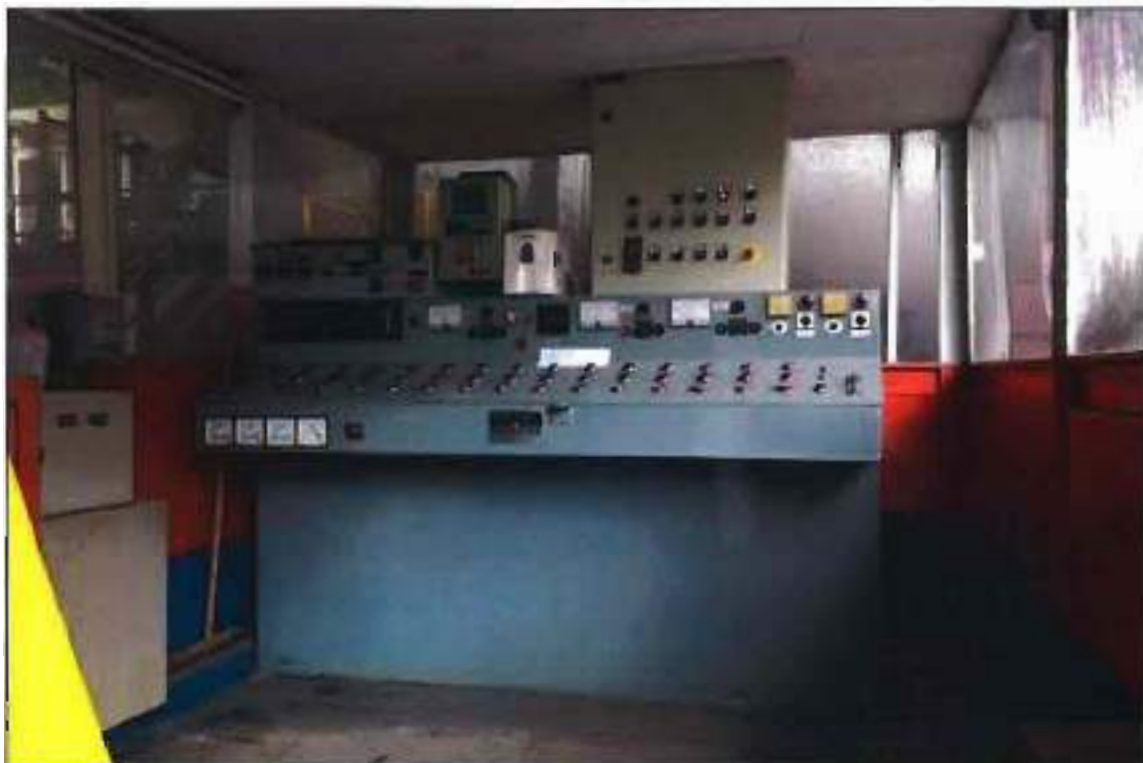
ITEM 1,002 - VISTA DO PAINEL DE CONTROLE DA LINHA USINA DE ASFALTO
