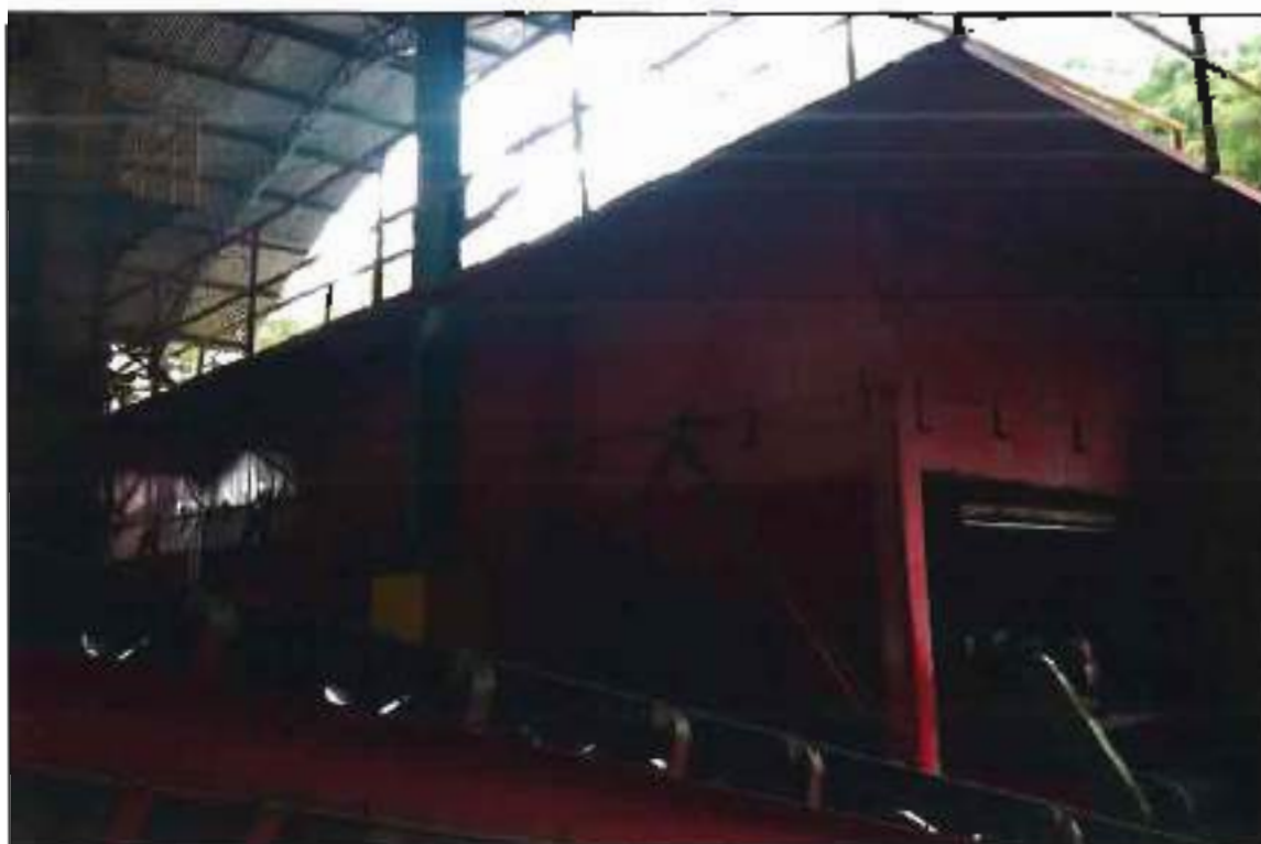
ITEM 1,002 - VISTA DO SILO COM 3 SAIDAS DA LINHA USINA DE ASFALTO
