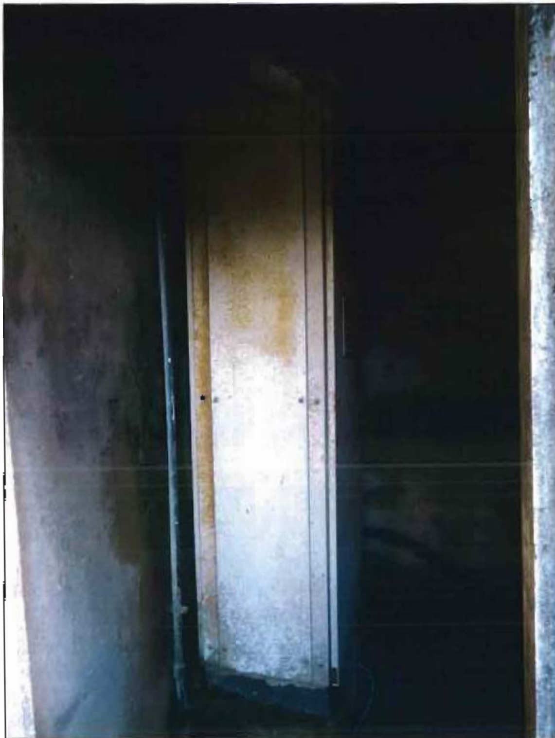
ITEM 1,901 – VISTA DA CAIXA DE ALTA TENSÃO DA LINHA CENTRAL DE CONCRETO
