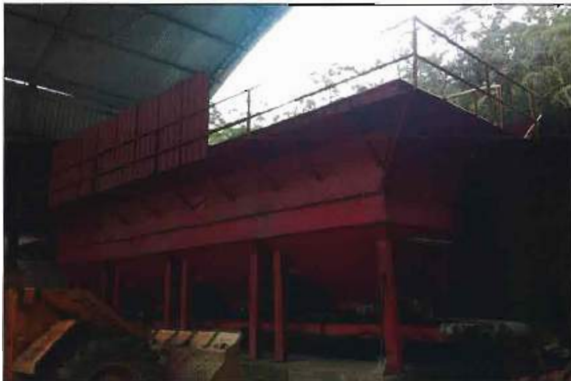
ITEM 1,003 – VISTA DO SILO COM 3 SAIDAS DA LINHA USINA DE ASFALTO
