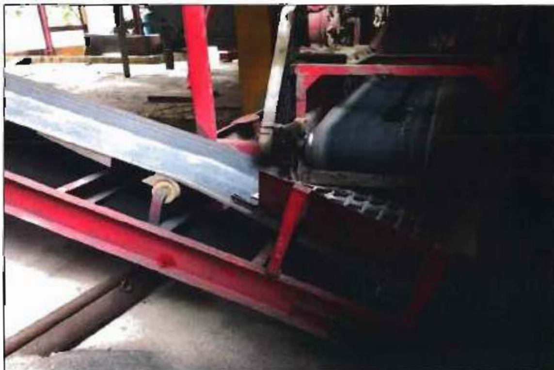
ITEM 1,002 - VISTA DA CORREIA TRANSPORTADORA DA LINHA USINA DE ASFALTO
