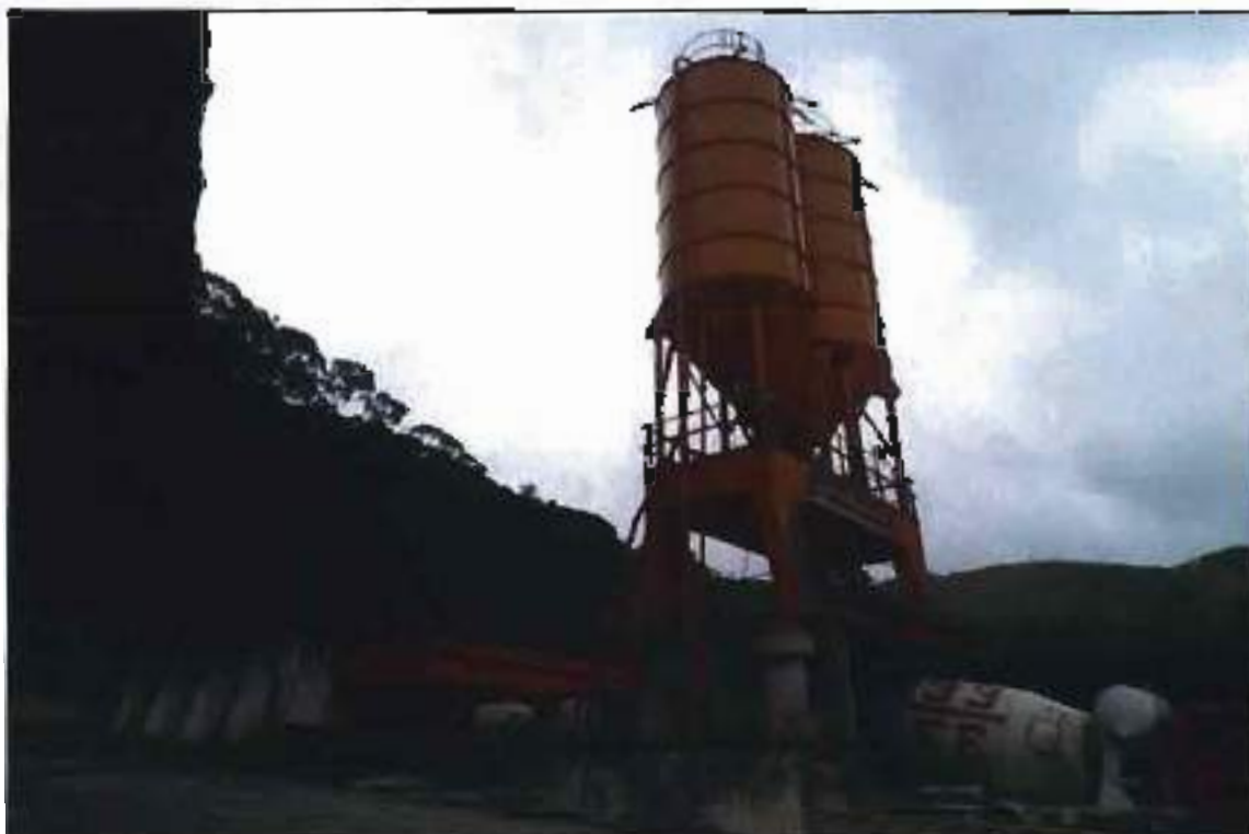
ITEM 1.001 - VISTA DO SILO DE CIMENTO E SILO A GRANEL DA LINHA CENTRAL DE CONCRETO
