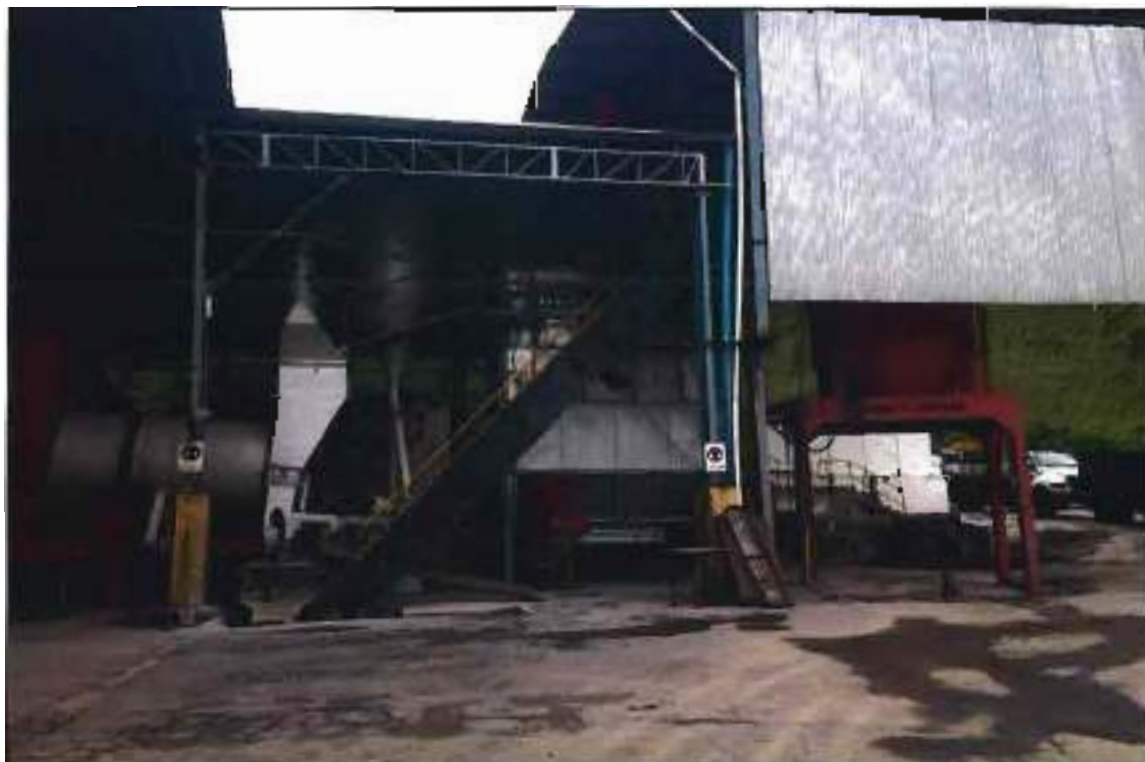
ITEM 1,002 - VISTA DA LINHA USINA DE ASFALTO COMPOSTA POR: SILO, FILTRO DE MANGA, EXAUSTOR, CHAMINE, CORREIA TRANSPORTADORA INCLINADA, SECADOR, CORREIA TRANSPORTADORA, SILO COM 3 SAIDAS E AQUECEDOR DE FLUIDO TERMICO MARCA: TENGE TIPO: TH-V40E-NG CAPACIDADE: 600000 KCAL/H SERIE: 1584 (ATENDE AS DUAS LINHAS DE ASFALTO)
