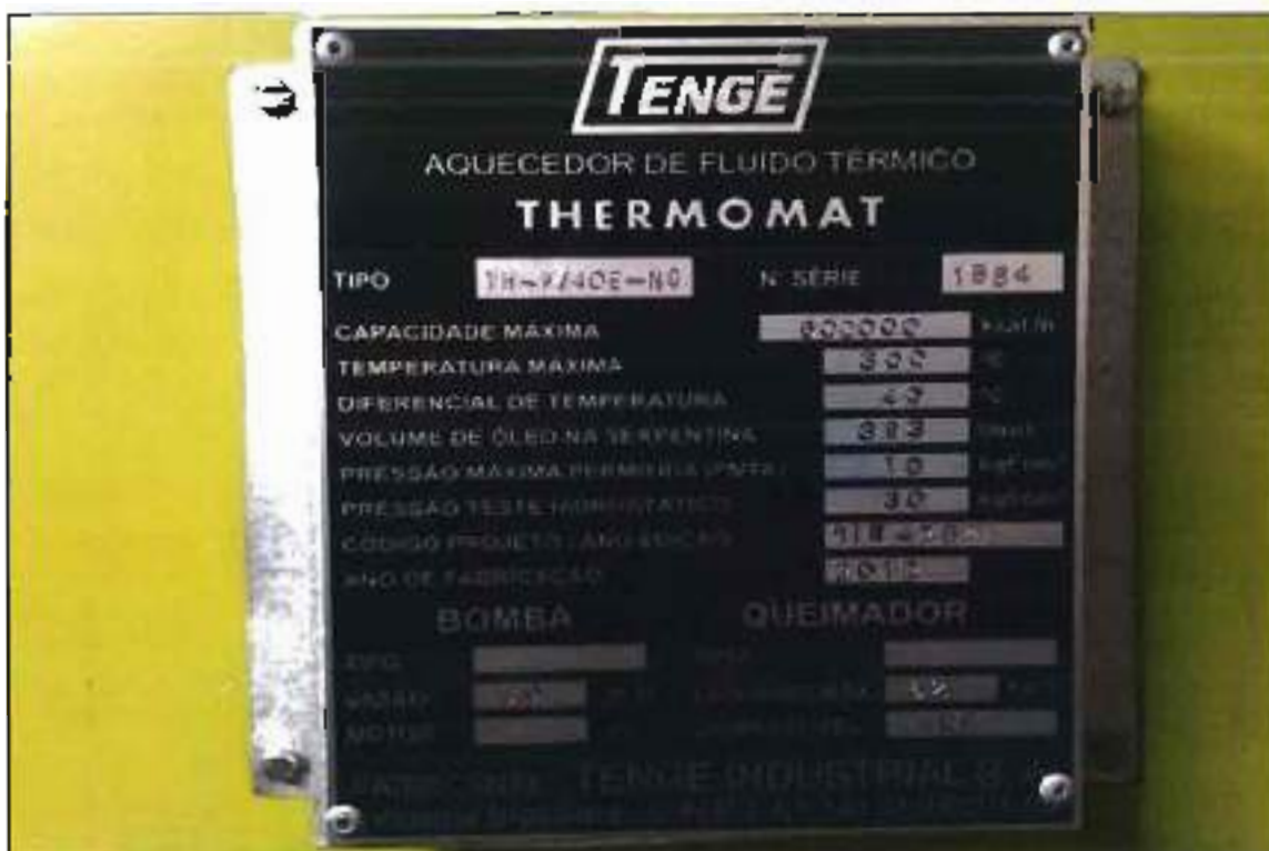
ITEM 1,002 - VISTA DA PLACA DE IDENTIFICAÇÃO DO AQUECEDOR DE FLUIDO TÉRMICO MARCA: TENGE TIPO: TH-V/40E-NG CAPACIDADE: 600000 KCAL/H SERIE: 1584 DA LINHA USINA DE ASFALTO
