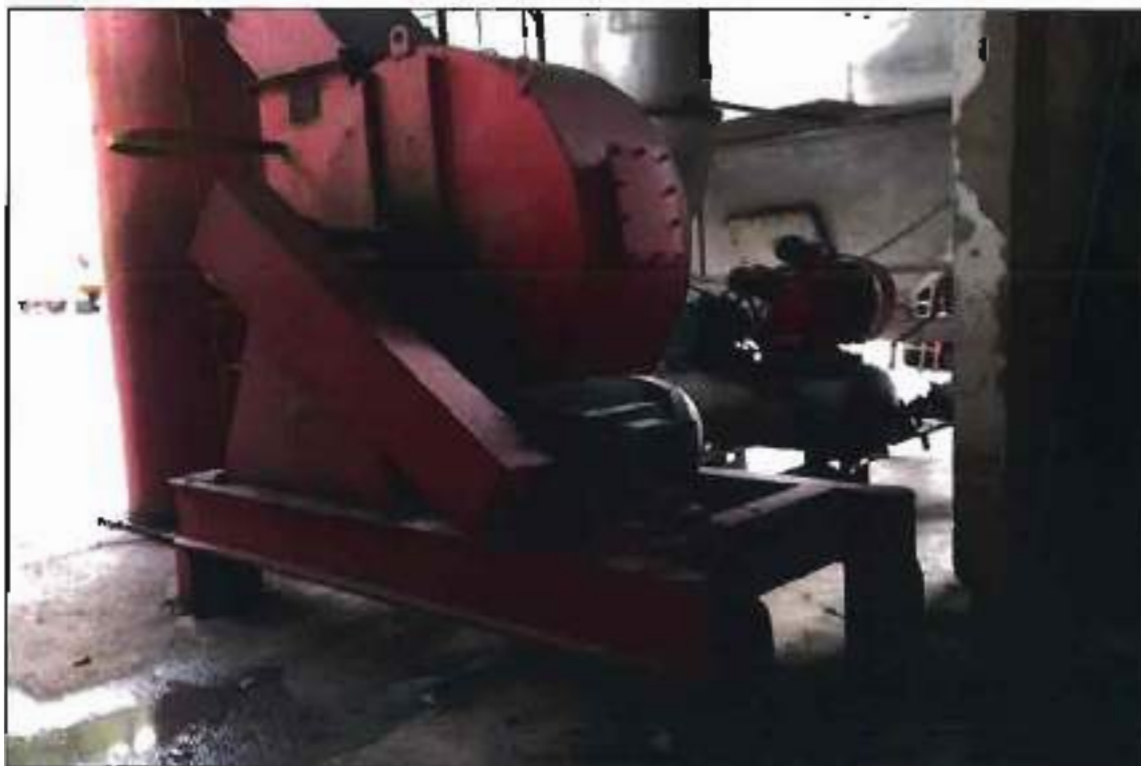
ITEM 1,012 – VISTA DO EXAUSTOR DA LINHA USINA DE ASFALTO
