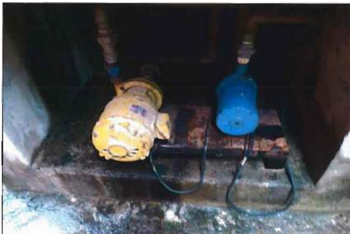
ITEM 1,001 - VISTA DA BOMBAS D'ÁGUA DA LINHA CENTRAL DE CONCRETO
