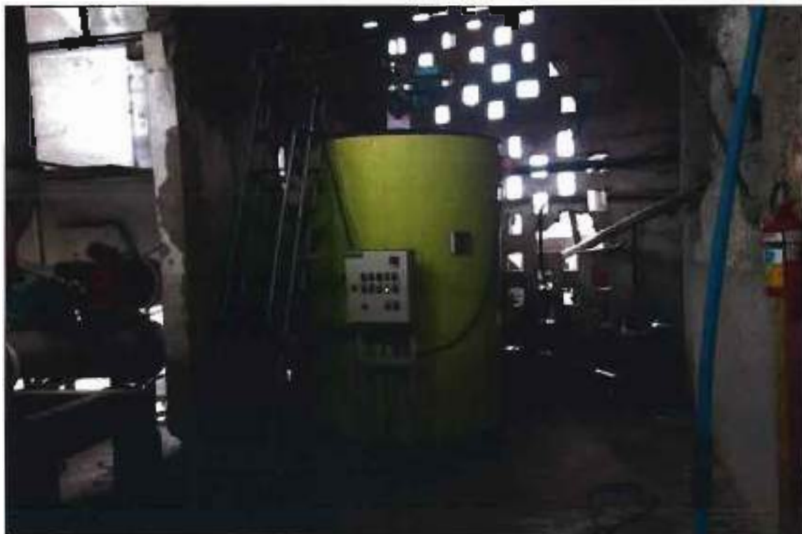
ITEM 1,002 - VISTA DO AQUECEDOR DE FLUIDO TÉRMICO MARCA: TENGE TIPO: TH-V/40E-NG CAPACIDADE: 600000 KCAL/H SERIE: 1584 DA LINHA USINA DE ASFALTO
