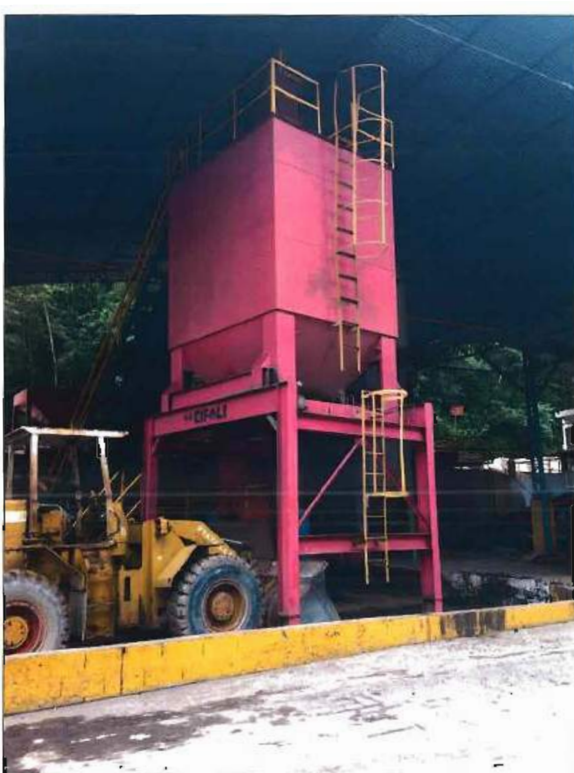
ITEM 1,003 – VISTA DO SILO DA LINHA USINA DE ASFALTO
