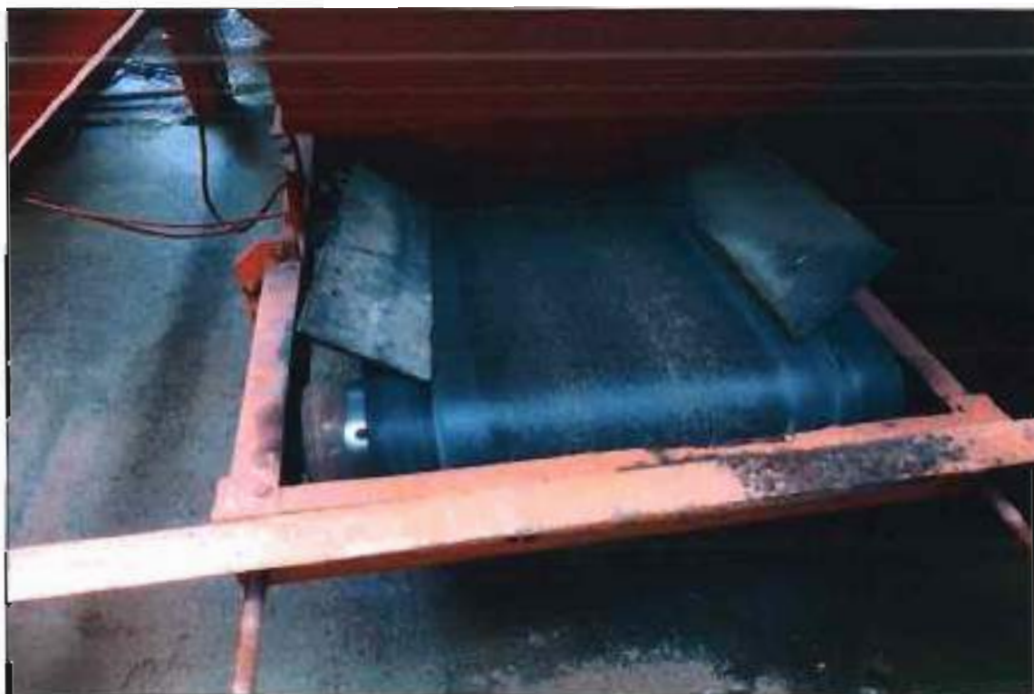
ITEM 1,001 - VISTA DA CORREIA DOSADORA DA LINHA CENTRAL DE CONCRETO
