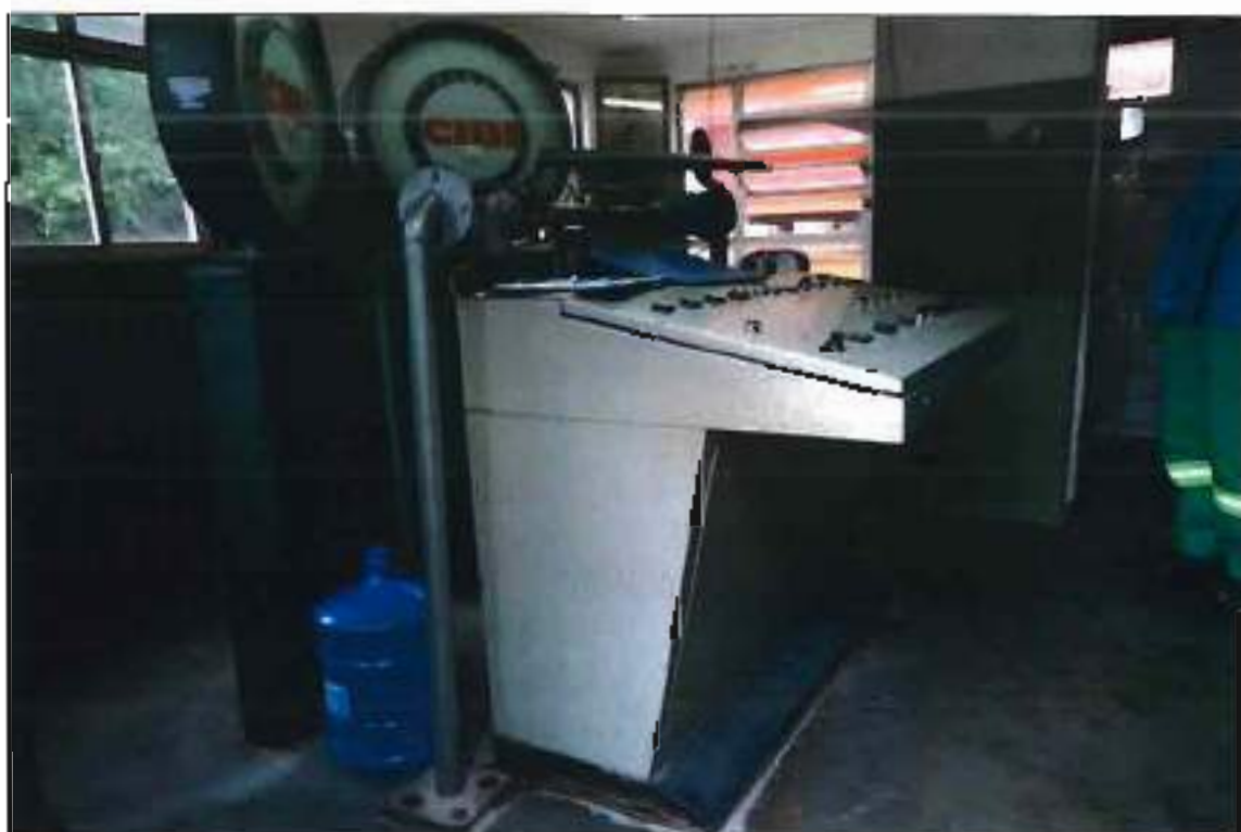
ITEM 1,001 - VISTA DO PAINEL DE CÔNTROLE DA LINHA CENTRAL DE CONCRETO
