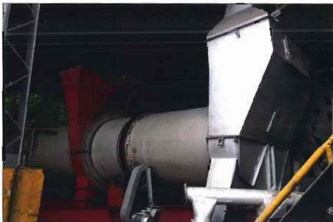
ITEM 1,002 - VISTA DO SECADOR DA LINHA USINA DE ASFALTO
