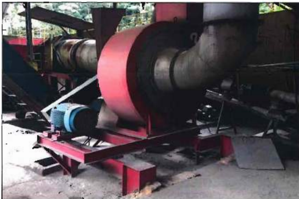
ITEM 1,003 - VISTA DO EXAUSTOR DA LINHA USINA DE ASFALTO
