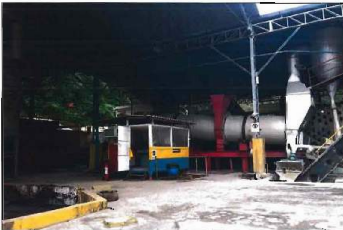
ITEM 1,002 - VISTA GERAL DA LINHA USINA DE ASFALTO
