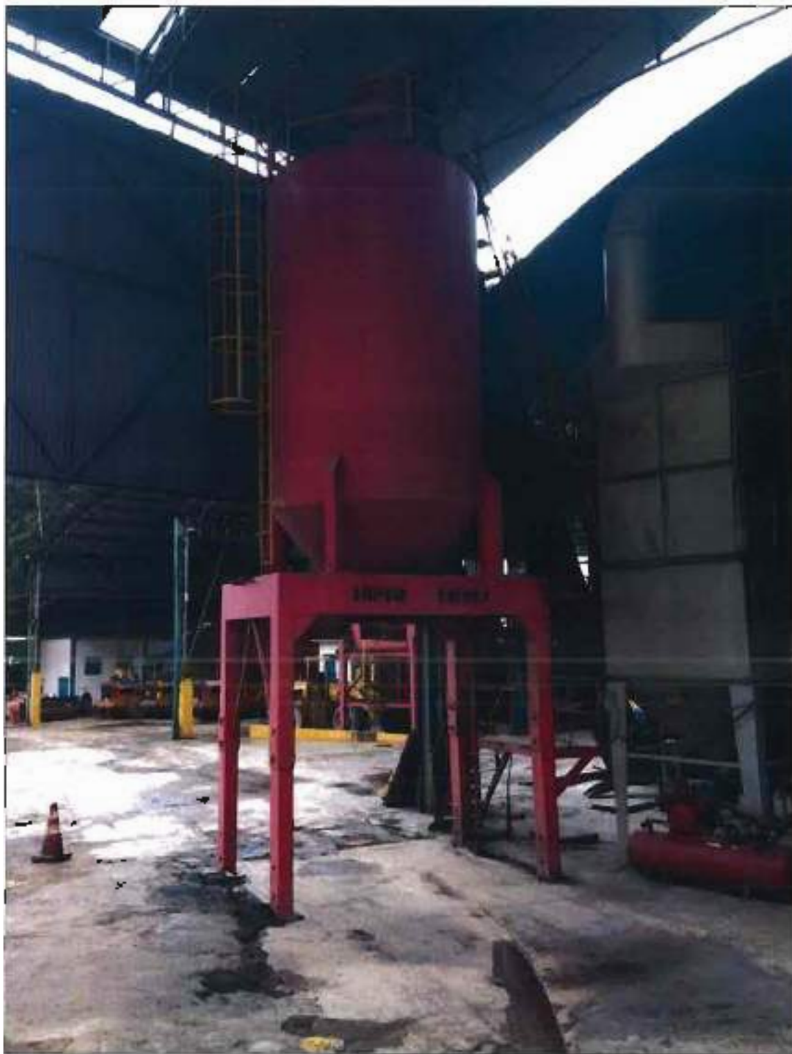
ITEM 1.002 - VISTA DO SILO DA LINHA USINA DE ASFALTO
