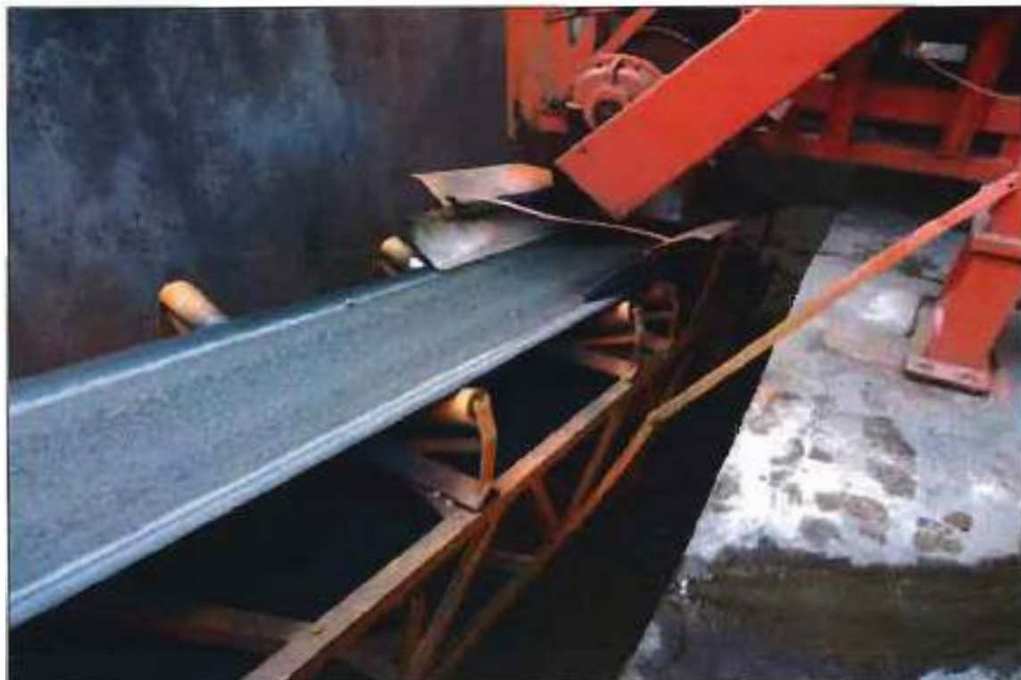
ITEM 1,001 - VISTA DA CORREIA TRANSPORTADORA INCLINADA DA LINHA CENTRAL DE CONCRETO
