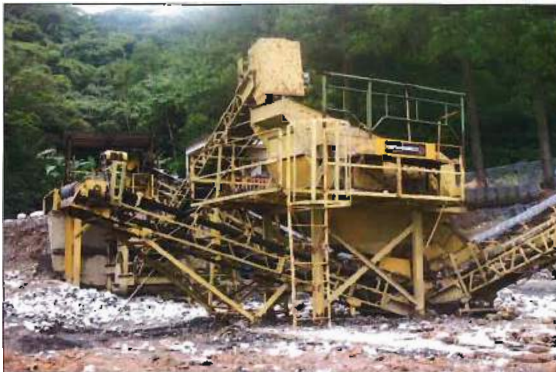
ITEM 1,004 - VISTA CENTRAL DE BRITAGEM COM BRITADOR PRIMARIO E SECUNDARIO MARCA: MAQBRIT
