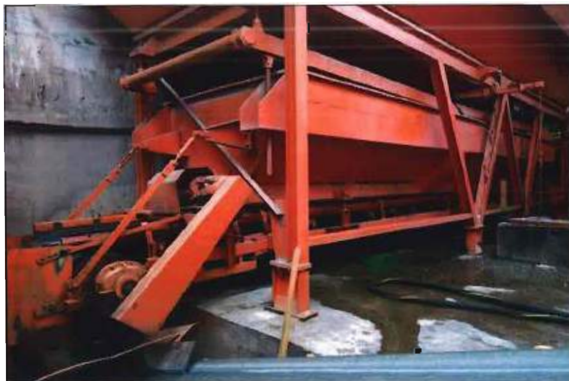
ITEM 1,001 - VISTA DA CAIXA DE AGREGADO DA LINHA CENTRAL DE CONCRETO
