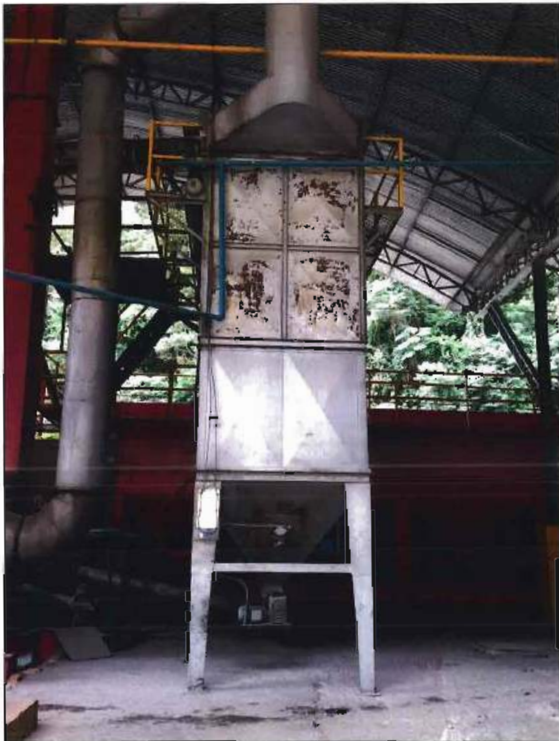
ITEM 1.003 – VISTA DO FILTRO DE MANGA DA LINHA USINA DE ASFALTO
