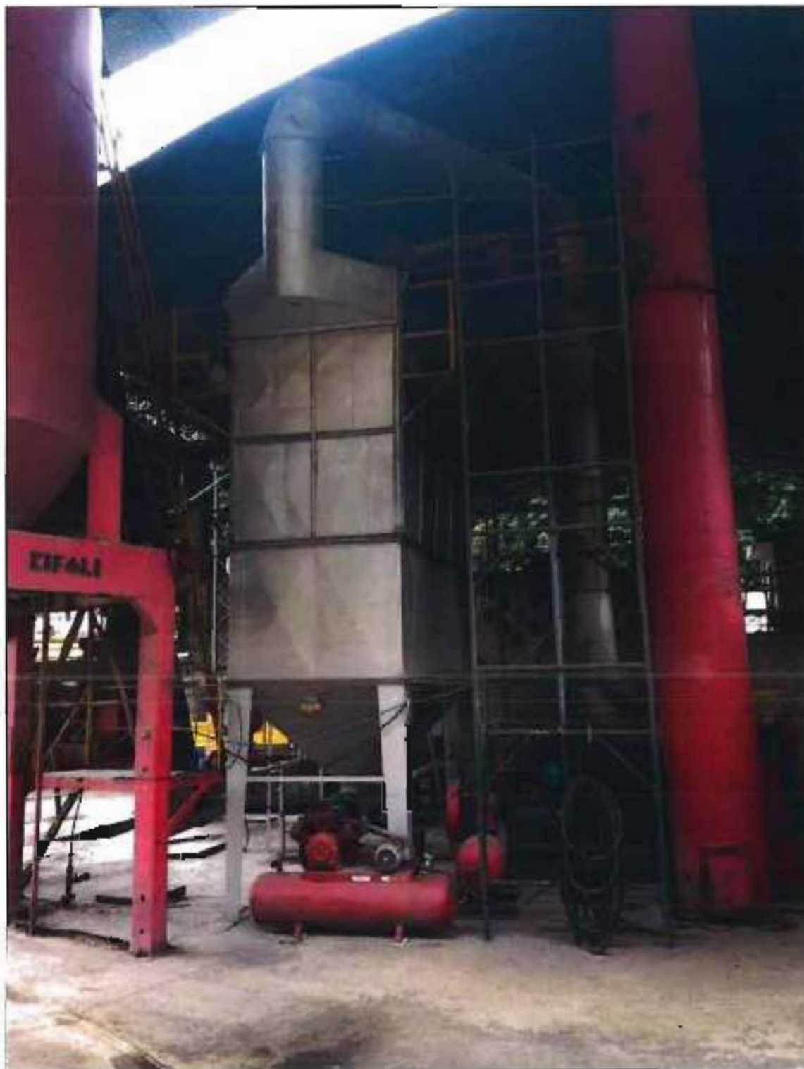
ITEM 1.002 - VISTA DO FILTRO DE MANGA DA LINHA USINA DE ASFALTO
