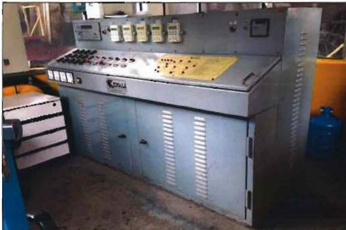
ITEM 1,003 - VISTA DO PAINEL DE COMANDO DA LINHA USINA DE ASFALTO
