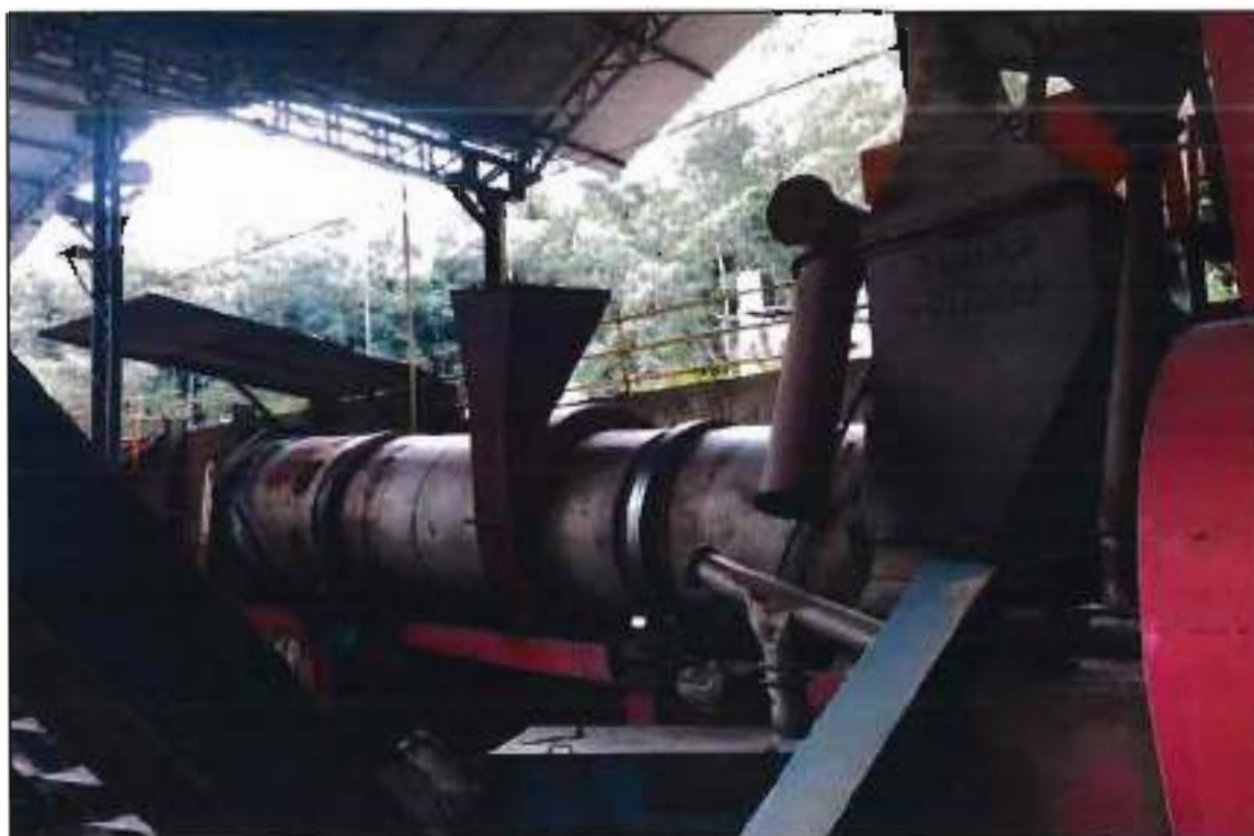
ITEM 1,003 – VISTA DO SECADOR DA LINHA USINA DE ASFALTO
