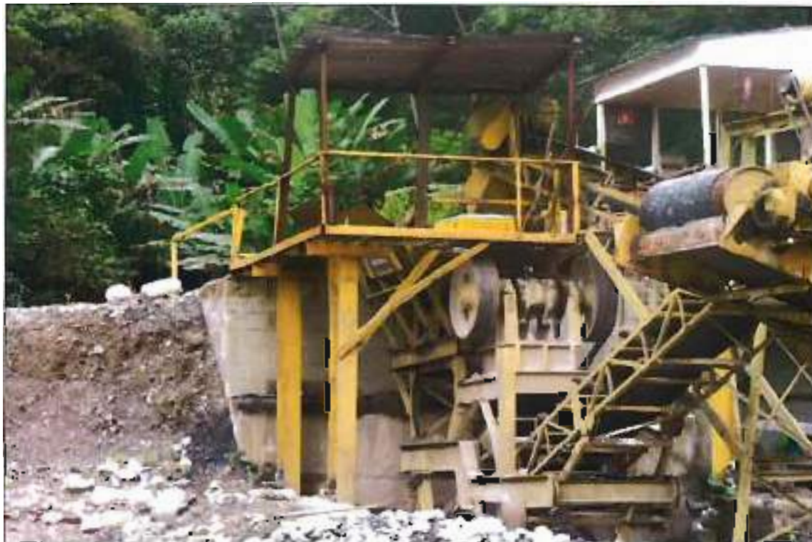
ITEM 1,004 - VISTA CENTRAL DE BRITAGEM COM BRITADOR PRIMARIO E SECUNDARIO MARCA: MAQBRIT
