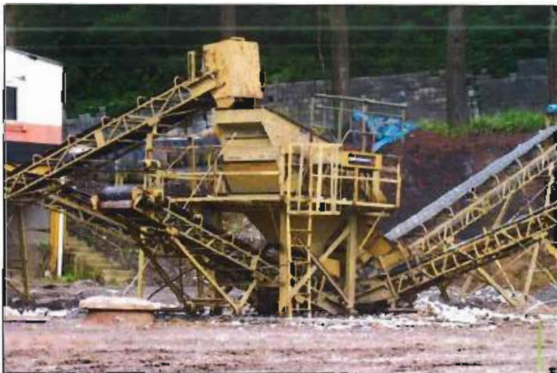
ITEM 1,004 - VISTA CENTRAL DE BRITAGEM COM BRITADOR PRIMARIO E SECUNDARIO MARCA: MAQBRIT
