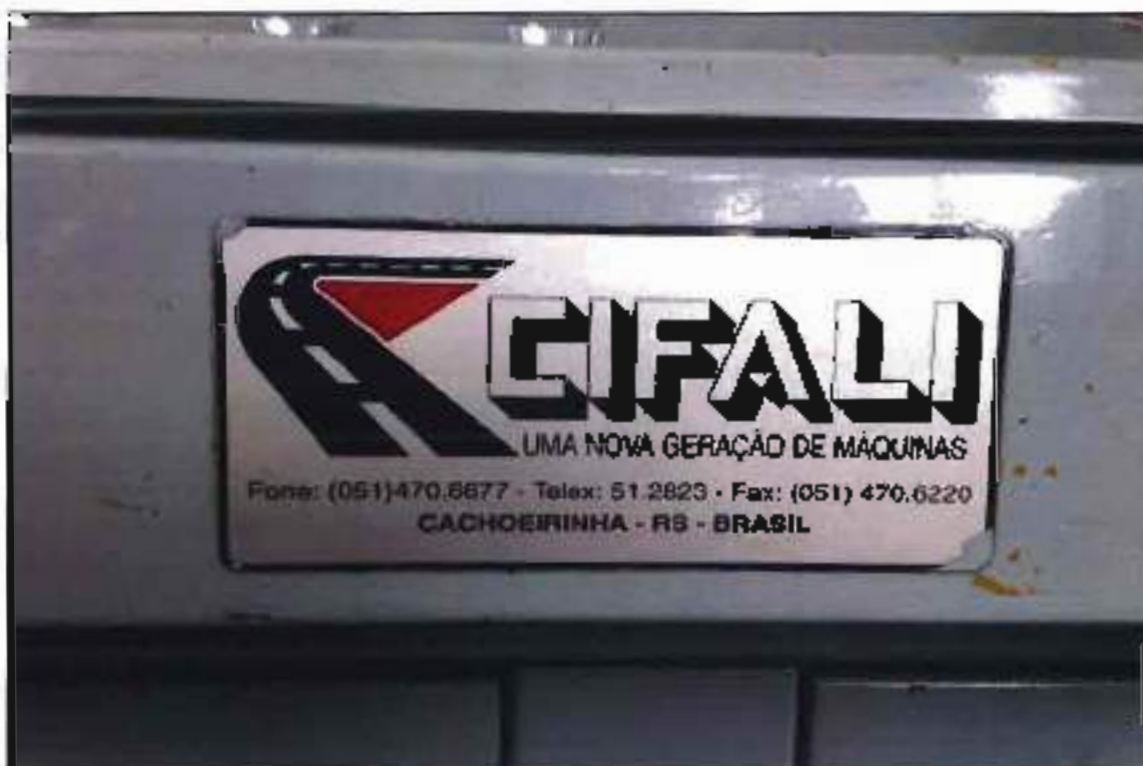
ITEM 1,003 - VISTA DA PLACA DE IDENTIFICAÇÃO DO PAINEL DE COMANDO DA LINHA USINA DE ASFALTO
