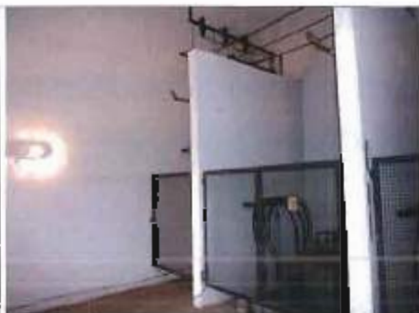
Cabine de força
